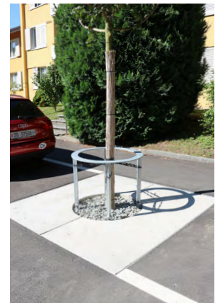
Abdeckung aus Beton-Halbplatten
